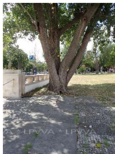
Fig. 5. Danos provocados no pavimento pelas raízes do exemplar.
