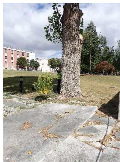
Fig. 6. Danos provocados no pavimentos pelas raízes do exemplar
