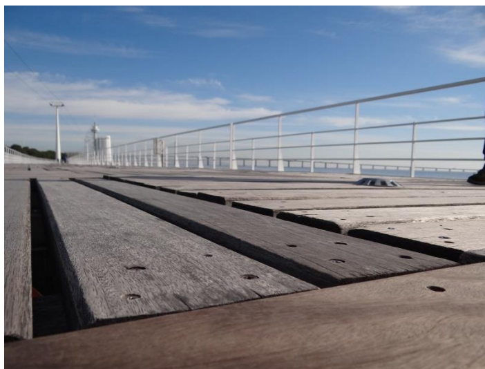
Figura 16 – Pormenor de desnível no revestimento de madeira.
