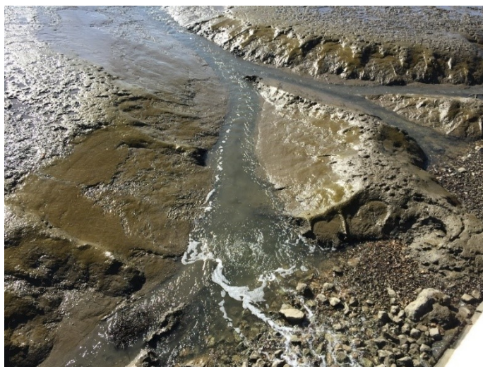
Figura 2.3 – Vista do dique em direção ao rio. Resultado provocado pelas escorrências identificadas nas fotos anteriores.
