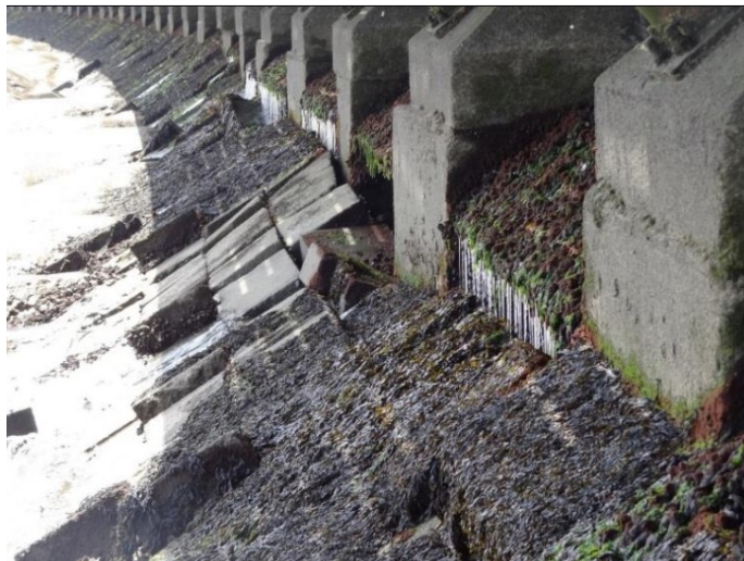
Figura 2.2 – Face exterior do dique em zona com assentamento e danos relevantes (fonte: BETAR). É visível a escorrência superficial de água entre maciços (1º e 3º a 5º vãos) e através do dique (2º vão)
