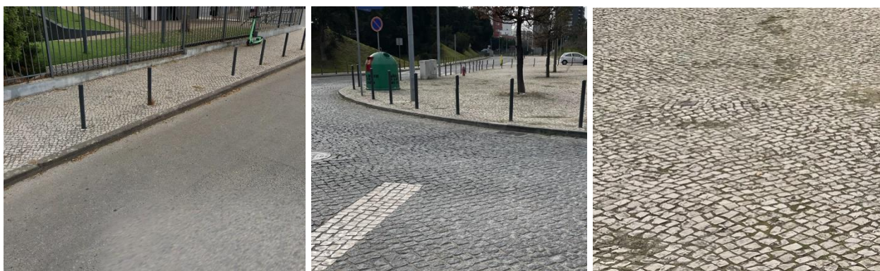
Figura 8 - Principais materiais a utilizar na intervenção (propostos e existentes na área a intervir)
