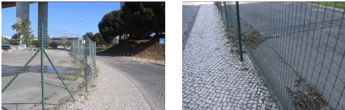
Figura 21 – Valeta existente afetada pelo ajustamento do perfil transversal do arruamento.
