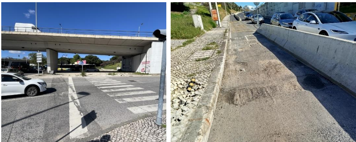
Figura 8 — Patologias nos pavimentos betuminosos existentes nas passeadeiras da Av. Mar. Gomes da Costa
