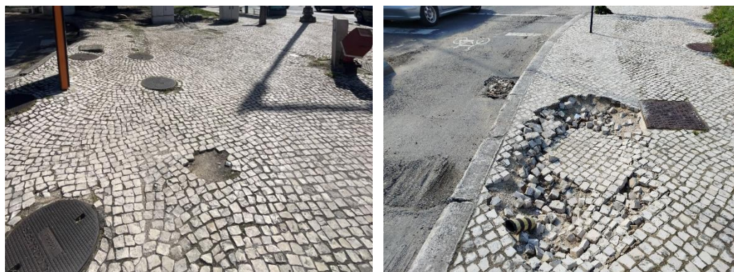
Figura 9 — Patologias nos passeios existentes aos km 0+041 e km 0+140
